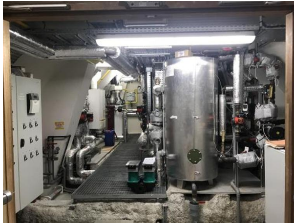
Chaufferie accessible depuis le 2 ème étage de l'EHPAD
