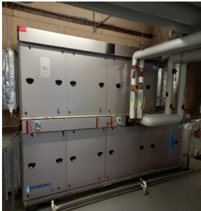
Centrale de traitement d'air
