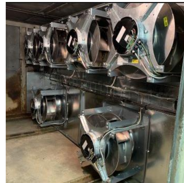
« Mur » de moteurs en courant continu
