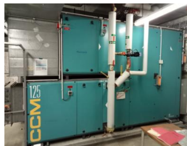
Centrale de Traitement d'Air
